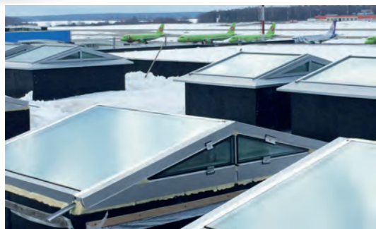
Зенитные фонари с подогревом, аэропорт Домодедово
